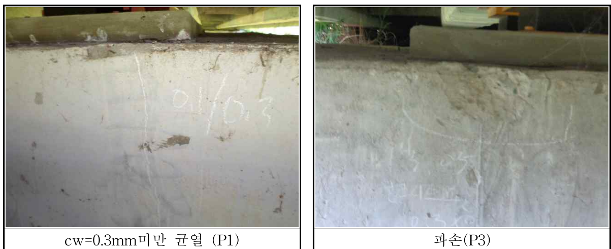
【그림 3.19】 교각 손상 현황
