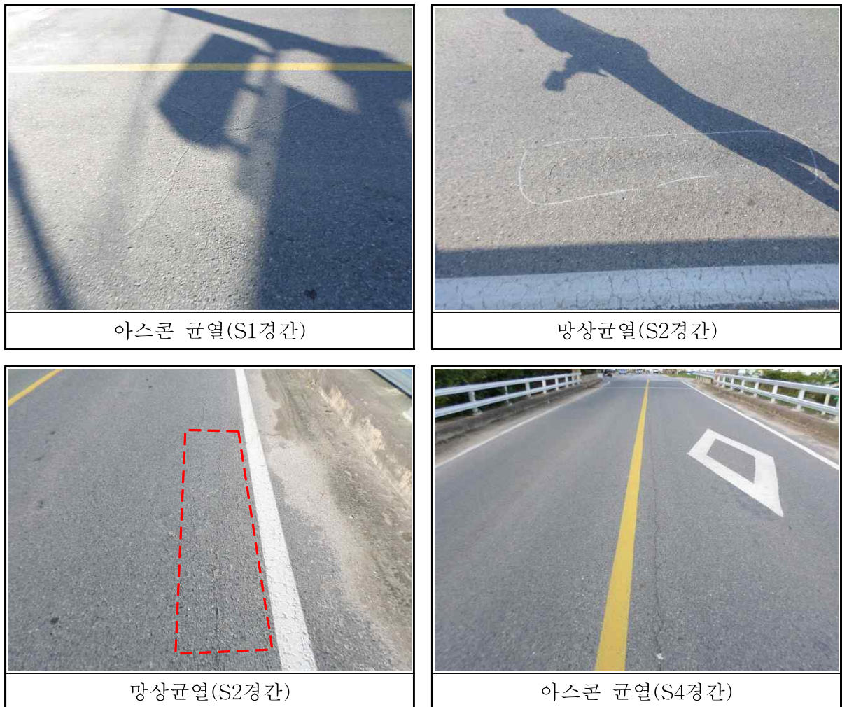
【그림 3.5】 교면포장 손상 현황
