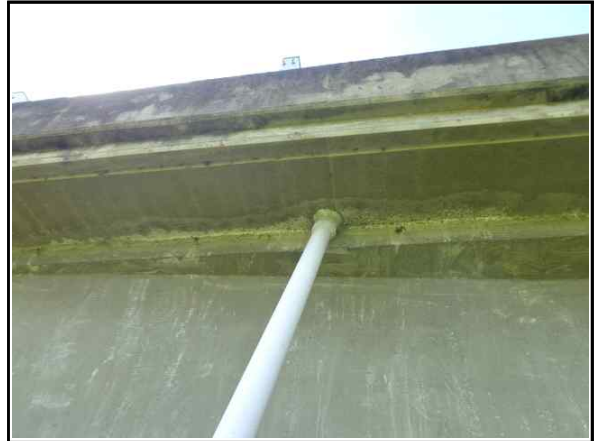
집수구 설치공간 부족(BEAM간섭)
